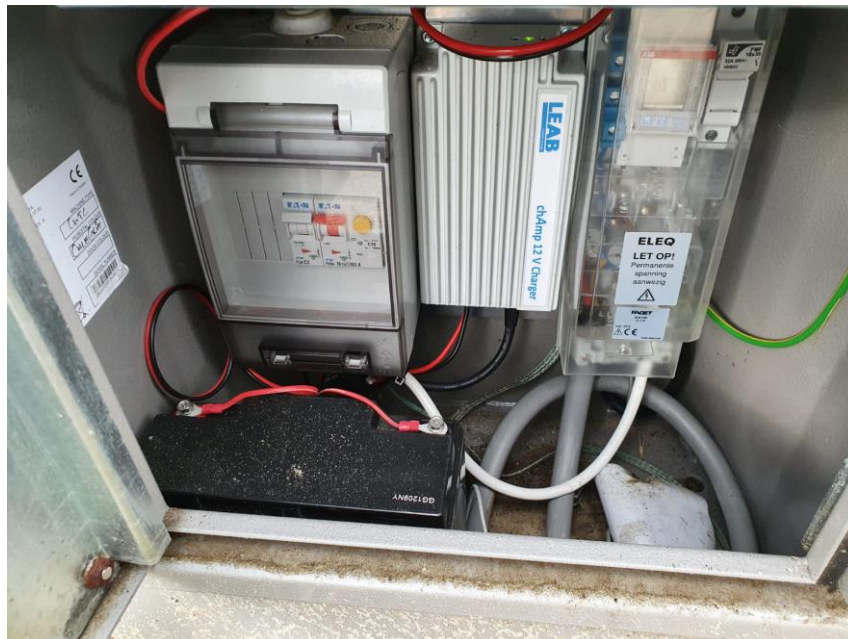
Figuur 1 - Kwh-meter en zekeringskast in Parkeerautomaat
