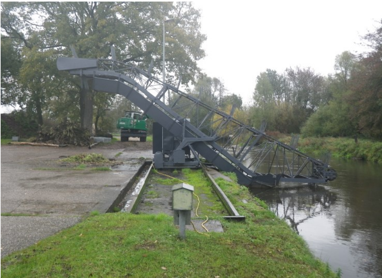
Afbeelding van de huidige in operatie zijnde installatie in Goch, net over de grens in Duitsland
