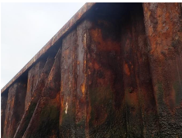
Figuur 7.5: Corrosie aan de damwanden.
