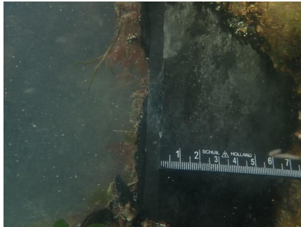
Figuur 7.2: Putcorrosie onder de waterlijn.
