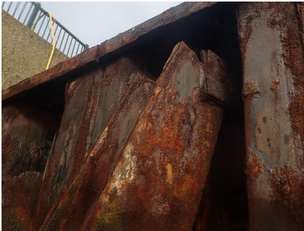
Figuur 7.1: Corrosie schoorprofiel.
