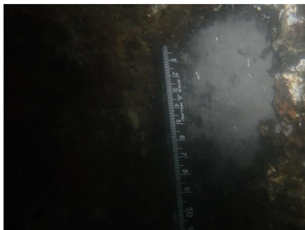
Figuur 7.6: Damwand onder de waterlijn.
