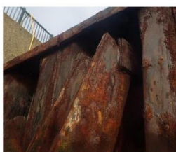
Figuur 7.1: Corrosie schoorprofiel.
