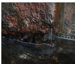
Figuur 7.3: Corrosie rond de waterlijn.
