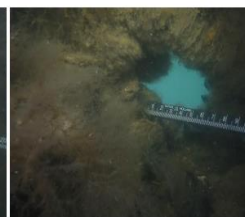
Figuur 7.8: Gat in de damwand.
