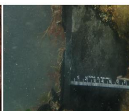
Figuur 7.2: Putcorrosie onder de waterlijn.
