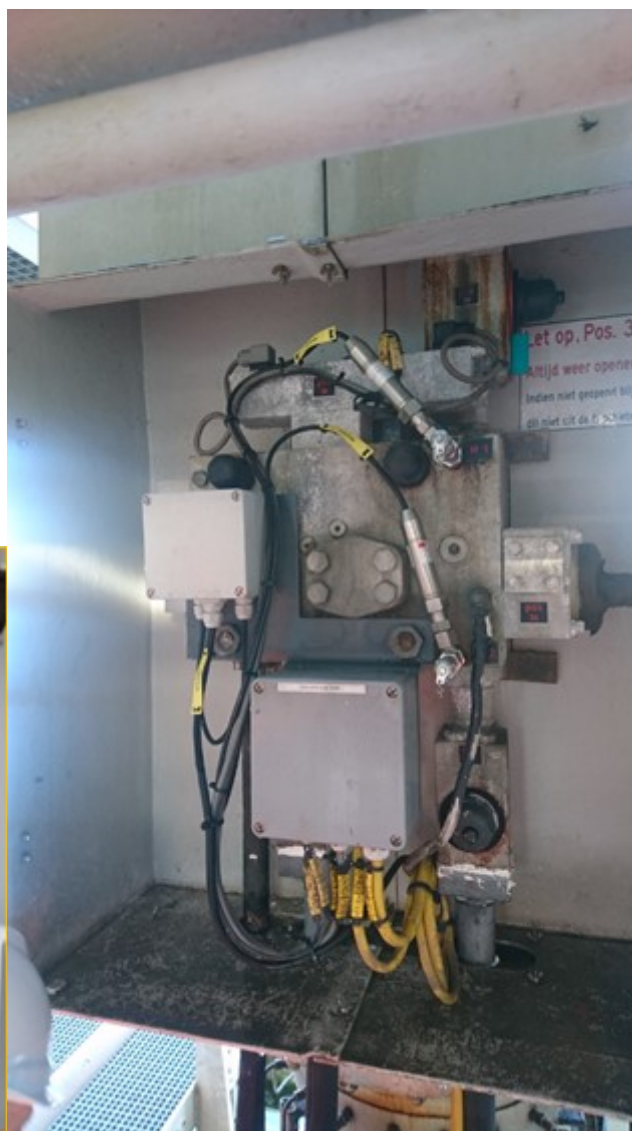
Figuur 5: Manifold in kast op de cilinder
