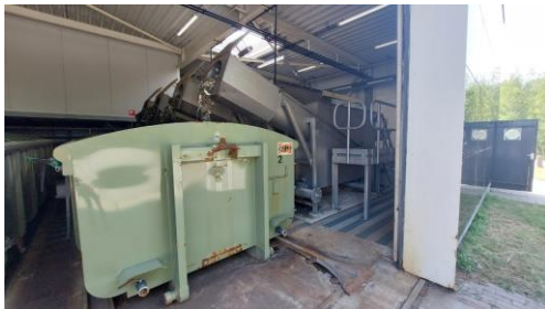
Afbeelding 1: Roostergoedinstallatie RWZI Eindhoven
