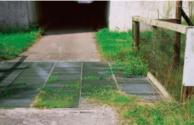
Onder: rooster is dichtgeslibd met zand.
