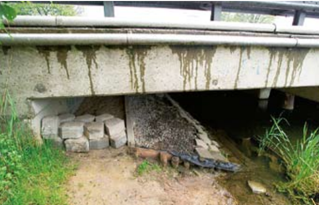
Onder: oever door stenen geblokkeerd.
