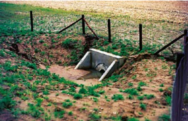
Onder: tunnel grotendeels volgelopen met water.
