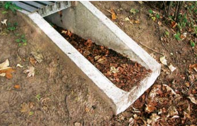
Onder: tunnel door drempel niet toegankelijk.
