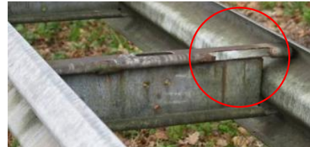
Afbeelding 11 Ernstige roestvorming veroorzaakt gaten in de afstandhouder
