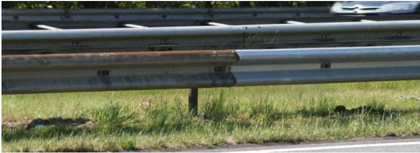
Afbeelding 35 Roestvorming aan de geleiderailconstructie
