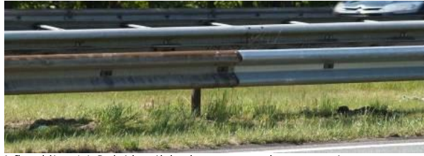
Afbeelding 14 Geleiderailplank aangetast door corrosie.
