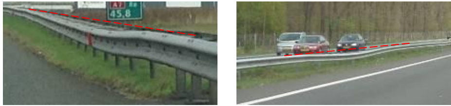
Afbeelding 6 Voorbeelden van verzakte geleiderailconstructie (verzakking)
