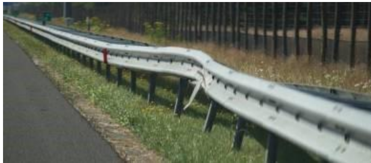
Afbeelding 1 Schade door een aanrijding.
