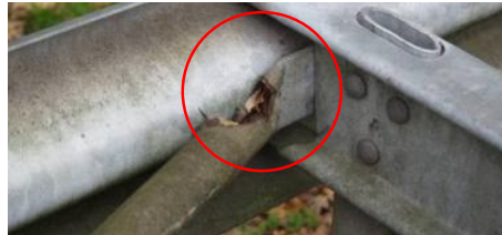
Afbeelding 10 Beschadigingen aan de diagonaal door roestvorming
