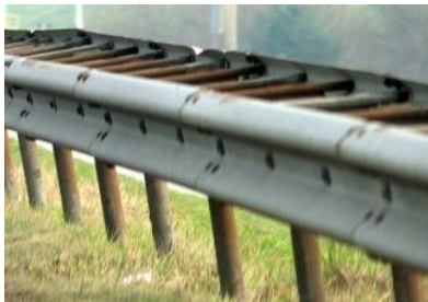
Afbeelding 34 Geleiderail en roestvorming
