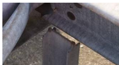
Afbeelding 29 Montagelip is volledig afgescheurd
