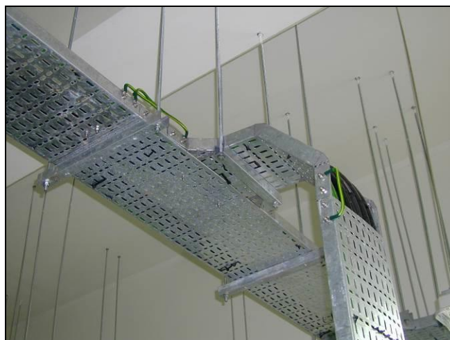
A Koppeling kabelgoot – apparatuurkast
