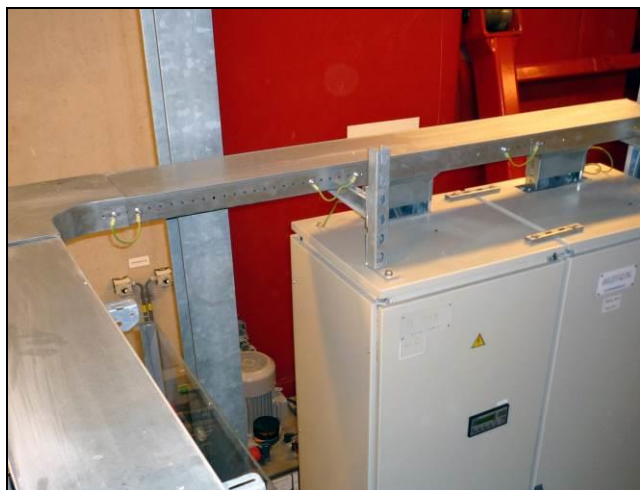
A Koppeling kabelgoot – apparatuurkast
