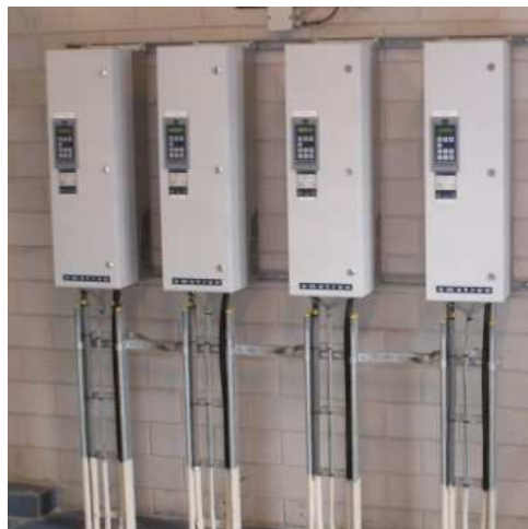
Fig. 19-5 : Frequentieomvormers in rioolgemaal Schagen (2011).
