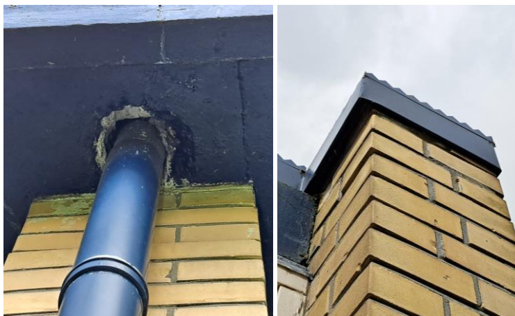
Figuur 3.2 Potentiële verblijfplaatsen van vleermuizen in de voormalige Woldschool: open stootvoegen (boven) en kieren bij regenpijpen en daklijsten (onder).
