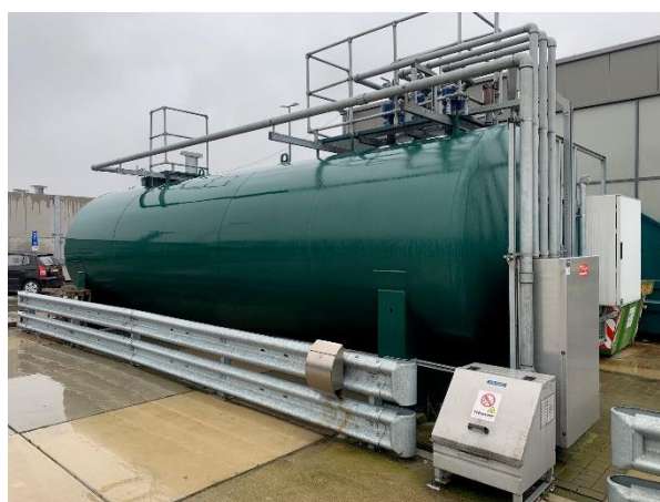
Dieseltank in buitenopstelling.
