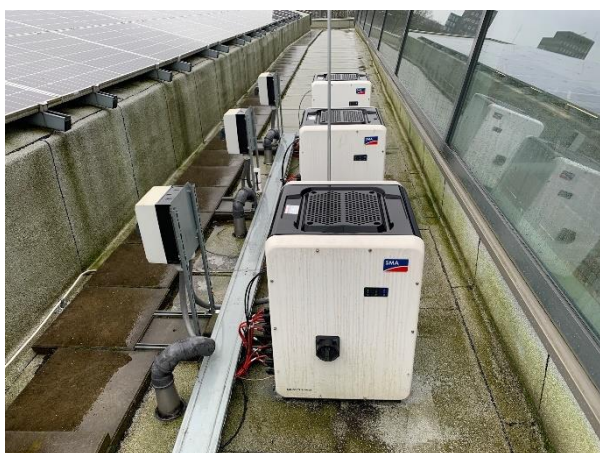
Omvormers opgesteld op het dak.
