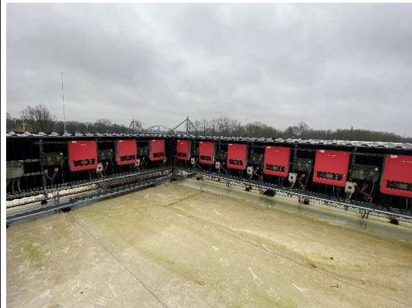
Omvormers PV installatie
