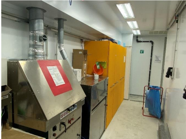
Inkijk in de mengruimte van de spuitery
