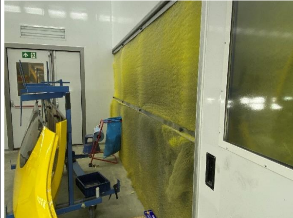
Droge spuitwand in de spuitery
