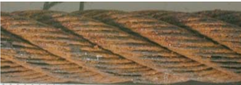
Classificatie : Klasse 3 (Onmiddellijke afkeur) Oppervlakte is ruw en vertoont zware pitten strengen van kabels staan open
