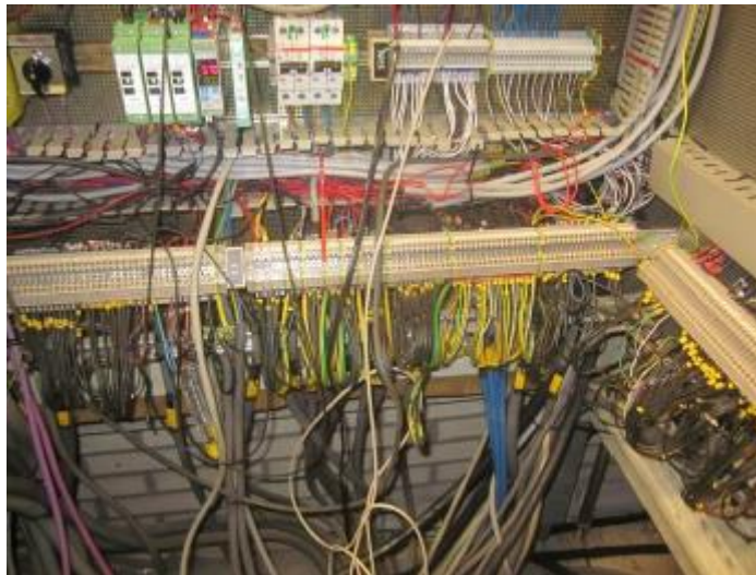
Fig. 10.1: Voorbeeld van overvolle kabelgoten en ontbreken trekontlasting.
