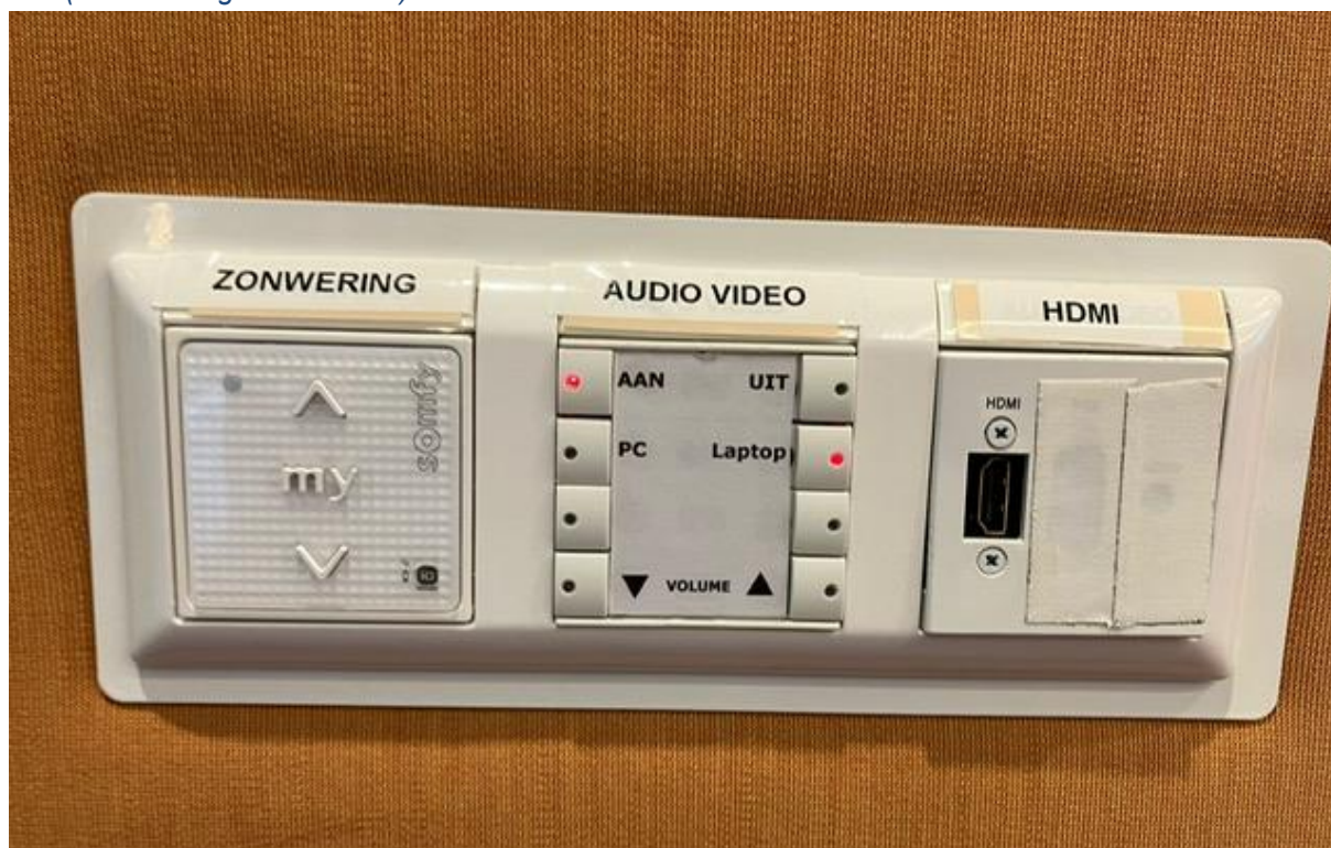
Foto 7: Bedieningspaneel per vergaderzaal in het vergadercentrum
