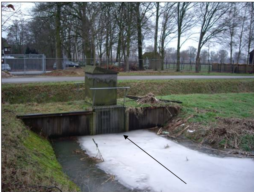
Foto B5.4: Gemaal Leemkuilen (peil geeft stromingsrichting aan)
