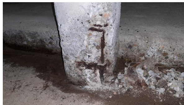
02] Aanzicht schade kolom
