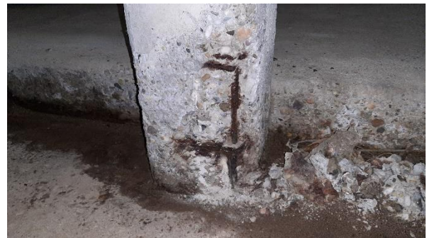
02] Aanzicht schade kolom
