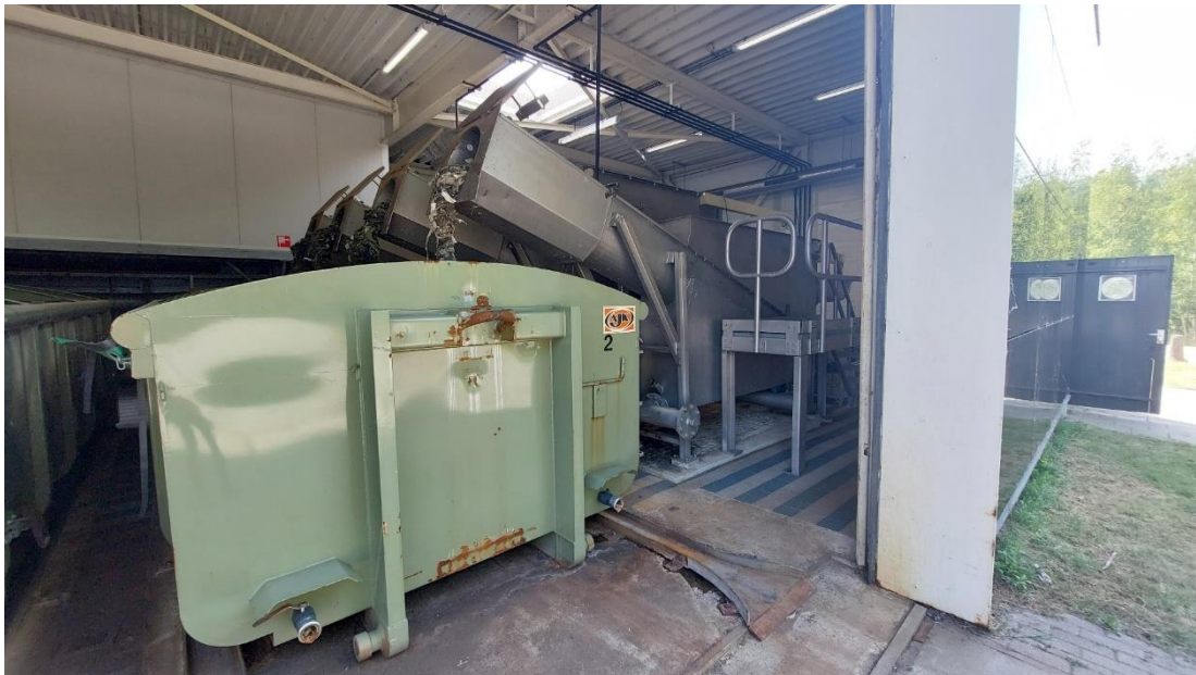
Afbeelding 1: Roostergoedinstallatie RWZI Eindhoven
