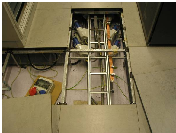
foto 4. computervloer ICT-computerruimte VL-post Amsterdam
