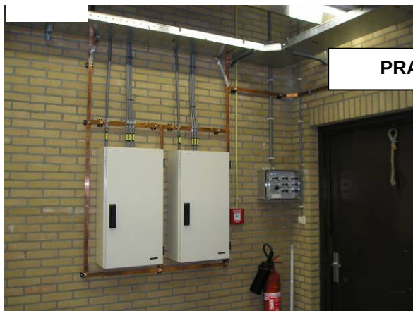
Foto 211, LS verdeelkast in relaisruimte (LPZ1-SR) VL-post Maastricht december 2008
