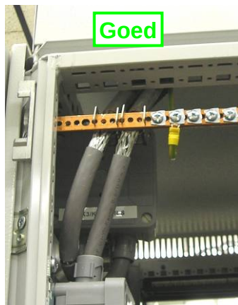
foto 12. Telecomruimte VL-post Rotterdam: Standaard YMvKas kabel voldoet als afscherming voor EM-zonering
