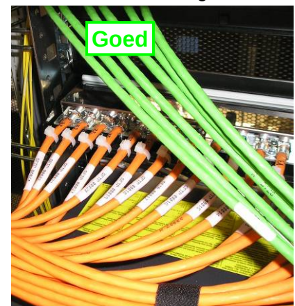
foto 16. SFTP kabels afgewerkt in een datakast.
