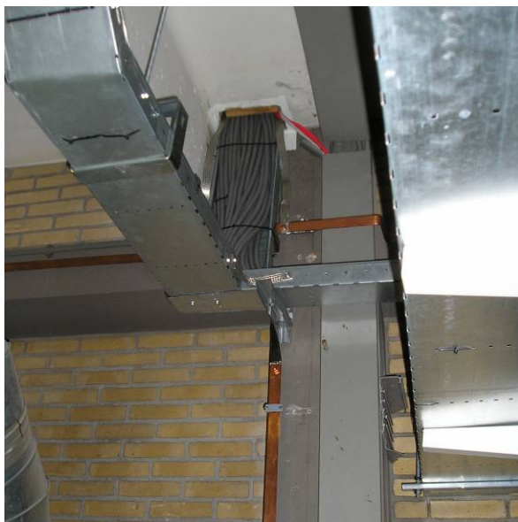
foto 17. VL-post Utrecht, potentiaalvereffening voedingkabels van voedingsruimte (LPZ1-SR) naar seinzaal (LPZ 2), aanzicht voedingsruimte
