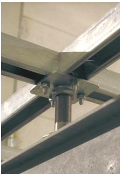
foto 1. Detail Installatie vloer; C-profielen met hamerkopschroeven elektrisch geleidend verbonden, zodat deze constructie zelfstandig onderdeel van een aardnet kan zijn
