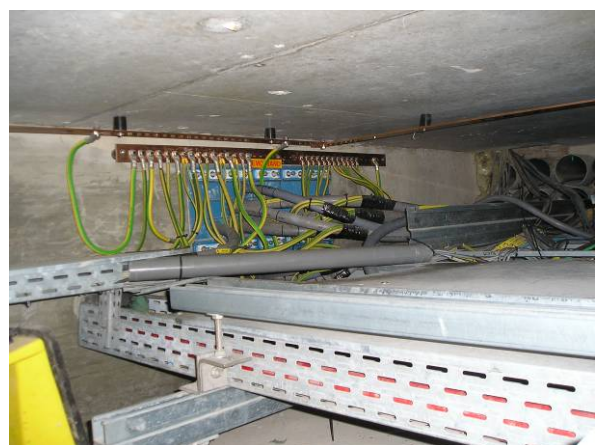
foto 7. Kabelinvoer dienstgebouw Botlek tunnel
