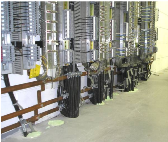
foto 6. RH10 Waalhaven aansluiting Noord, potentiaalvereffening treinbeveiliging kabels onder kabelverdeler als verlengstuk van de ringleiding in de kruipruimte
