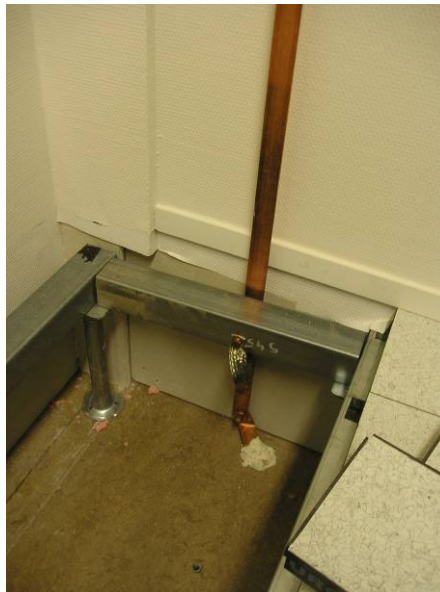
foto 2. computervloer ICT-computerruimte VL-post Eindhoven
