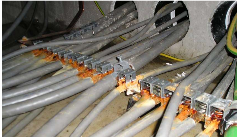
foto 5. Corrosieschade bij potentiaalvereffening van bekabeling in de kruipruimte waarin water is binnengetrepen.
