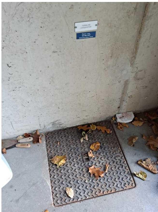
Uitvoer van de formaline (Vloeistof, laag calorisch)
