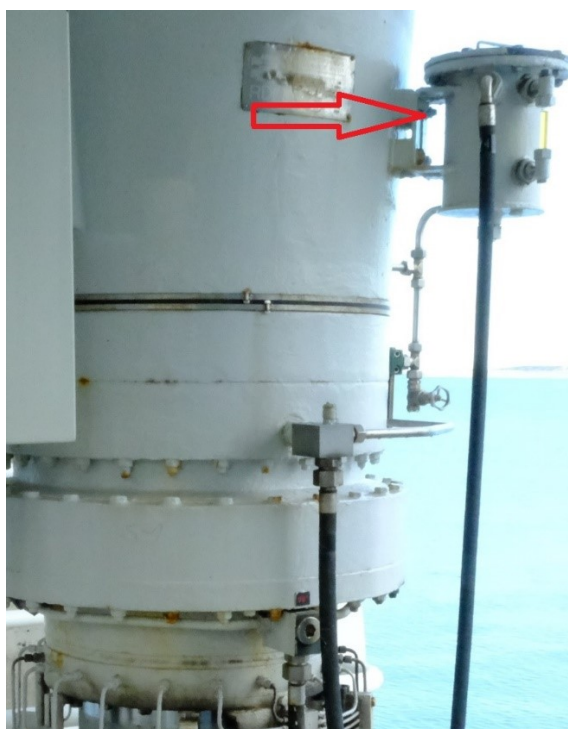
OBT-00139 Conserveringsinstallatie voorraadtank spoelolie
