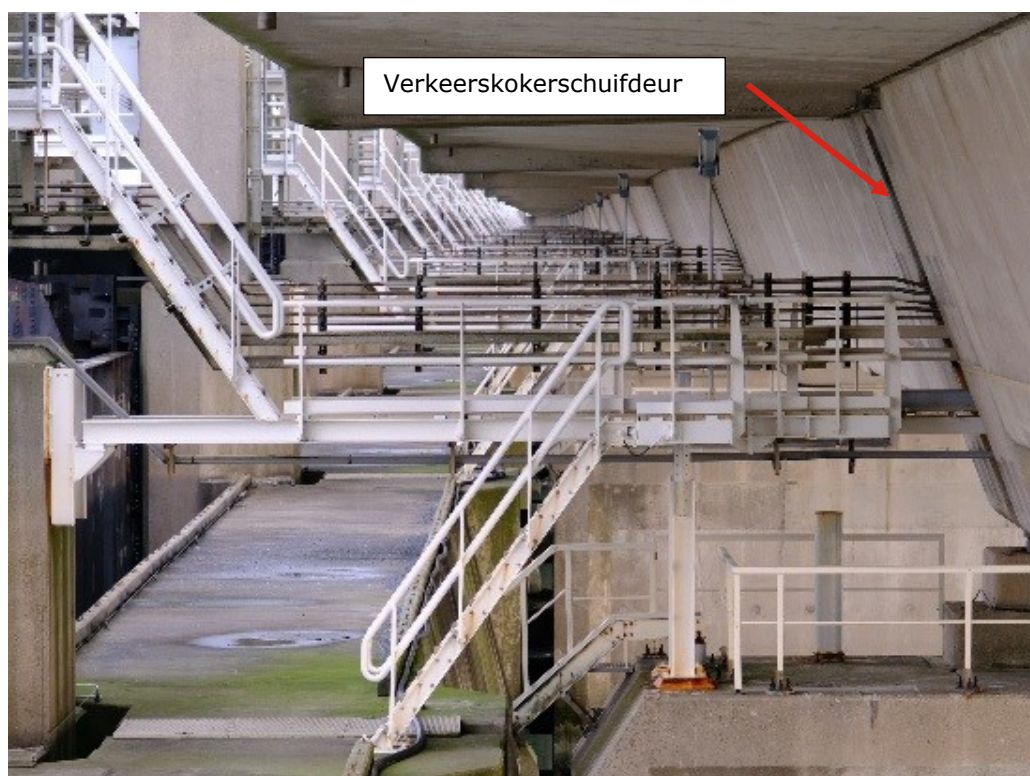
OBT-00015 Verkeerskokerschuifdeur (met loopbrug naar de Pijler)
