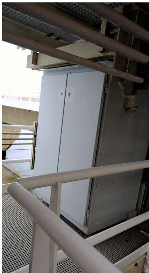
OBT-00073 Conserveringsolie-installatie kast
