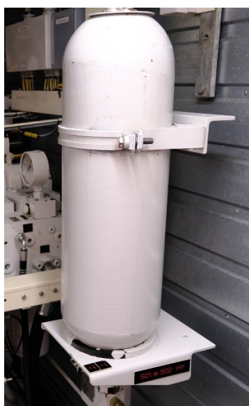
OBT-00094 accumulator in de container van de EH-eenheid
