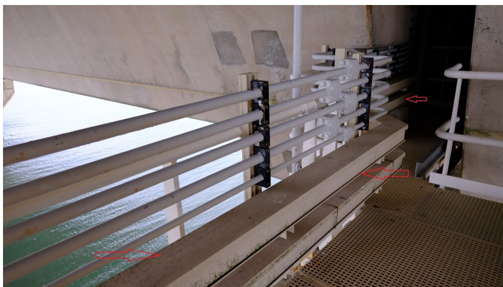
OBT-00105 Bekabeling van de EH-eenheid op de pijler
