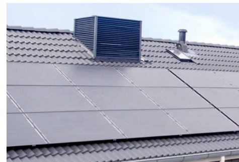
PV panelen en luchtwarmtepomp
