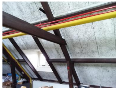
Overzicht rode leidingen zolder
