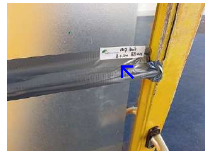
foto: afdichting - Lokaal 25a
