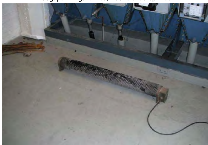
Hoogspanningsruimte, kachels los op vloer
