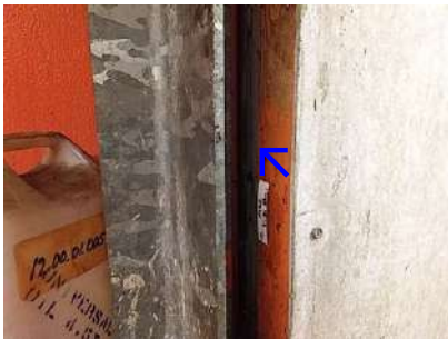
foto: afdichting - Liftmachinekamer
