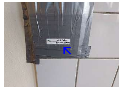
foto: lijmlaag - Lokaal 25a
