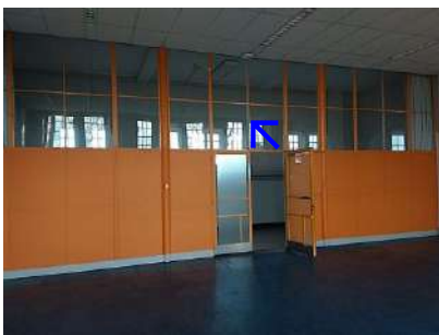
foto: afdichting - Lokaal 25a
