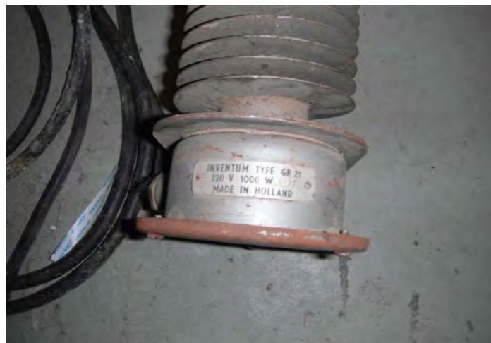
Hoogspanningsruimte, kachels los op vloer
