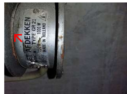
foto: pakking - Liftmachinekamer
