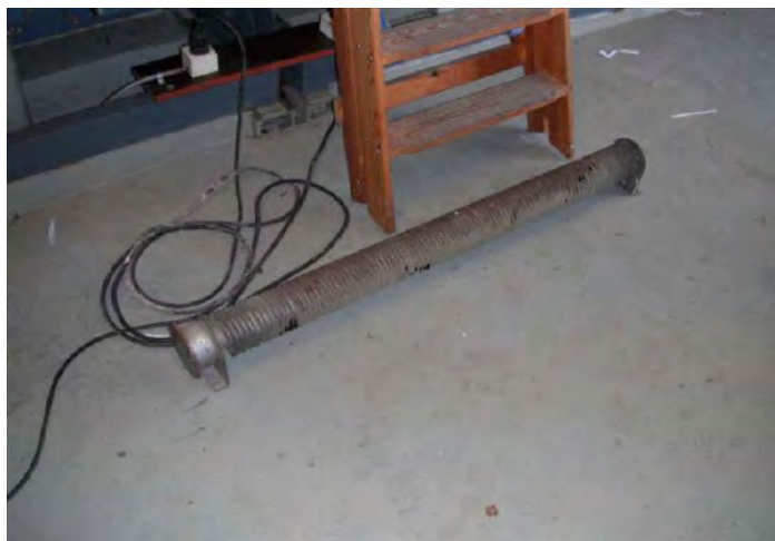
Hoogspanningsruimte, kachels los op vloer
