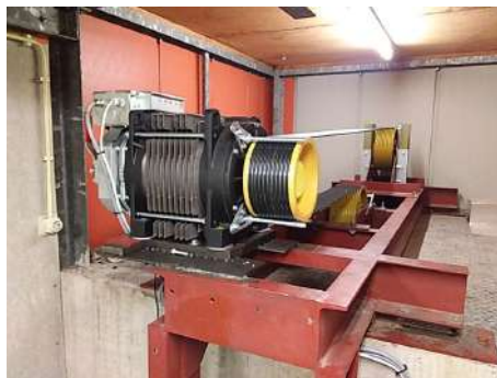
Liftheinstallatie niet asbestverdacht.
