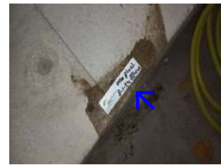
foto: brandafscheiding - CV ruimte
