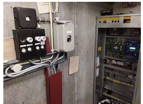
Noodstroomschakelaar niet asbestverdacht.
