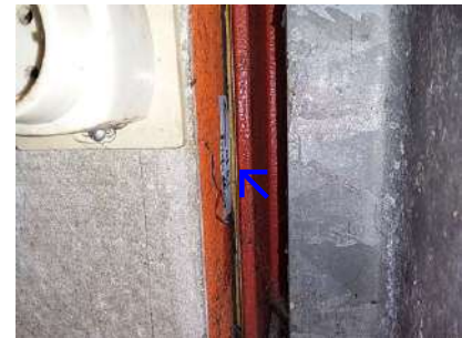
foto: afdichting - Liftmachinekamer
