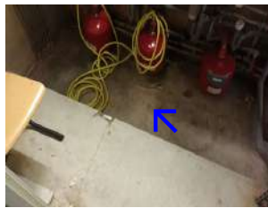
foto: brandafscheiding - CV ruimte
