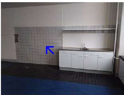
foto: lijmlaag - Lokaal 25a
