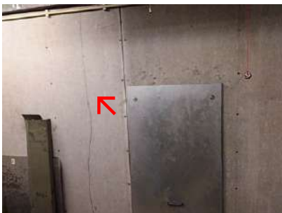
foto: plaat - Liftmachinekamer
