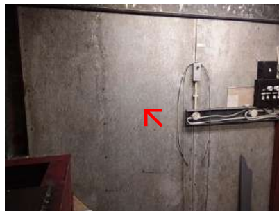
foto: plaat - Liftmachinekamer
