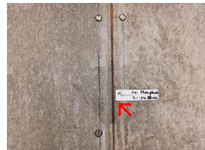
foto: plaat - Liftmachinekamer
