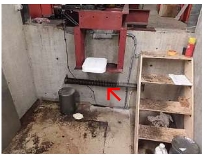
foto: pakking - Liftmachinekamer
