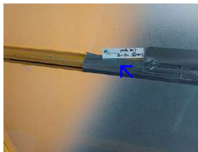
foto: afdichting - Lokaal 25a
