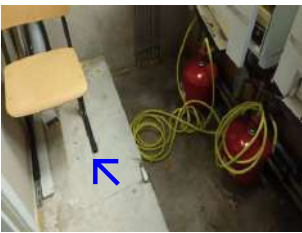
foto: brandafscheiding - CV ruimte
