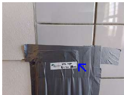
foto: lijmlaag - Lokaal 25a
