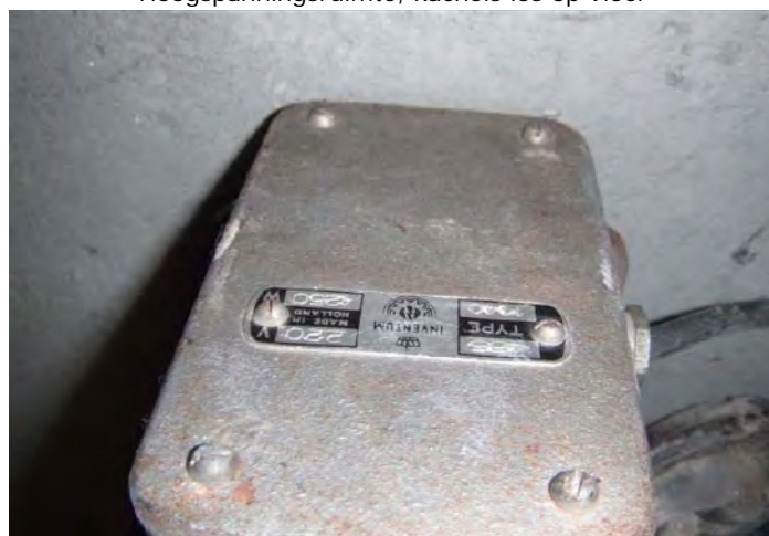
Hoogspanningsruimte, kachels los op vloer
