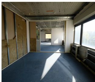
Huidige staat Stationsplein 16 na brand.
