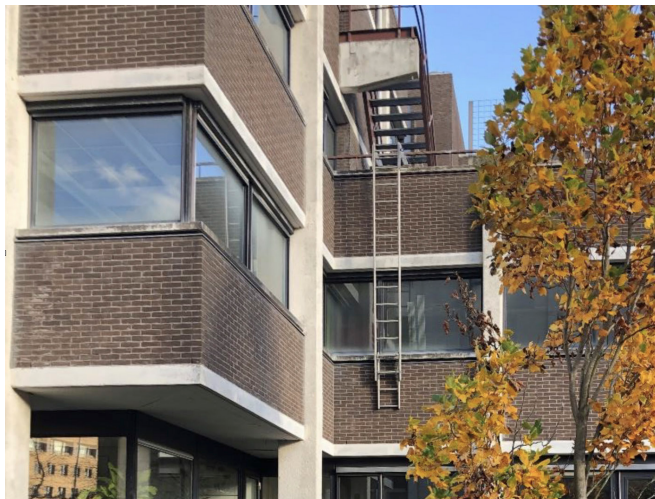
Nr. 16 - aluminium kozijnen met dubbel glas en geïntegreerde zonwering (later aangebracht) De brandladder voldoet niet aan huidige eisen. Er zijn geen zichtbare scheuren in beton of metselwerk.
