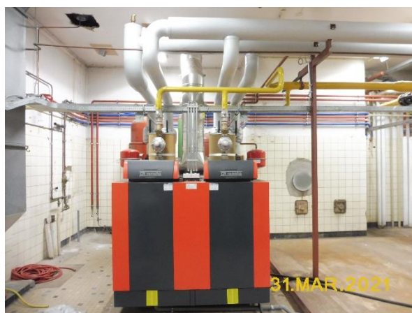
Inkijk in een van de CV-ruimten.
