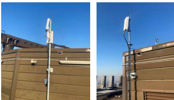
Figuur 1 gsm-antennes (2 stuks) langs de westgevel
