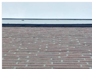
Figuur 5.5 Ruimte tussen de gevel en de dak omlijsting.
