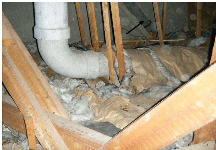
ontluchtingspijp op vliering (voor aantreffen besmetting en afbreken onderzoek)
