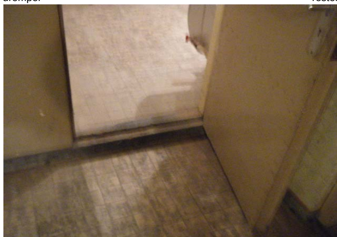
vloer bij cv-deur
