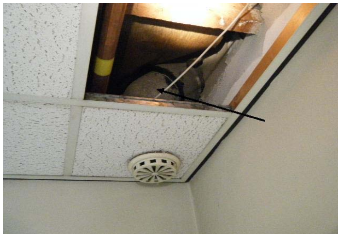
ontluchtingspijp in klaslokaal
