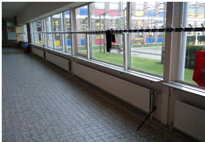
asbestplaat in gang
