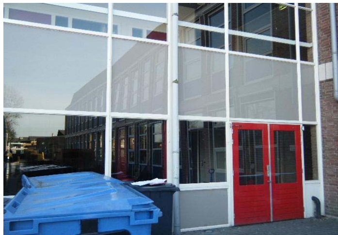
glasplaten aan buitenzijde, met erachter de asbestplaten
