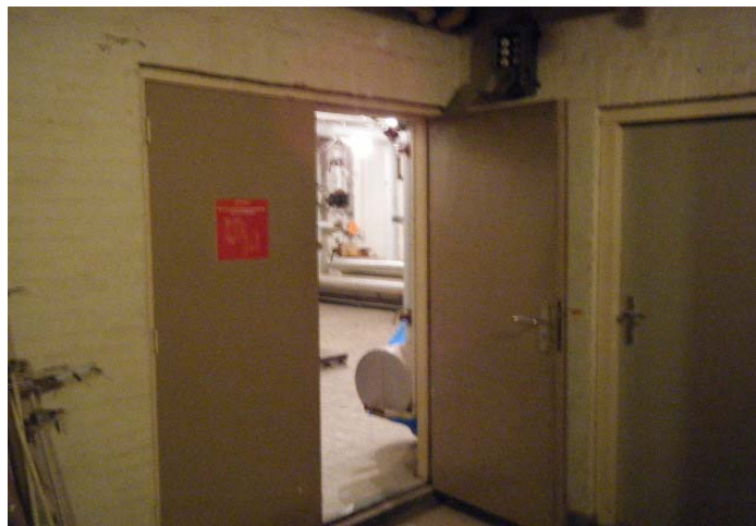
deur naar cv-ruimte
