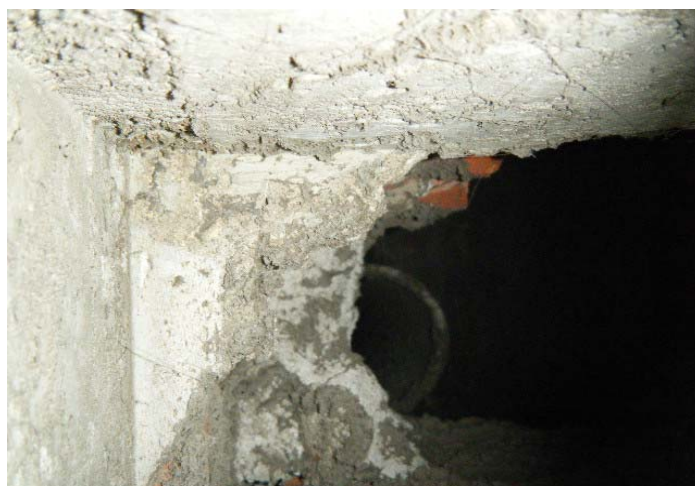
pijp in plafondgat toilet
