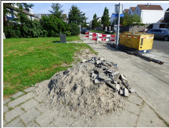
Foto 8 detail zand/steenhoop op locatie gemaal
