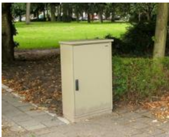
Figuur 2: Voorbeeld Kabelverdeelkast
