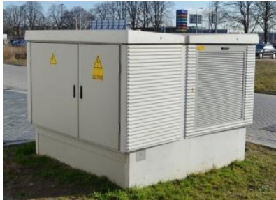
Figuur 1: Compactstation MS/LS-aansluiting (630 kVA)
