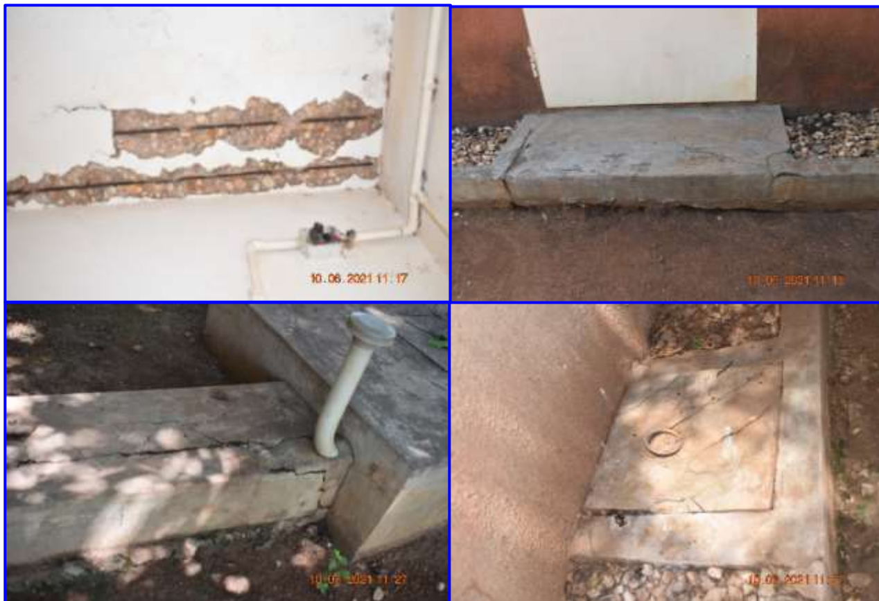
Photo 3 : Dégradations observées sur le bâtiment du site du forage 5
