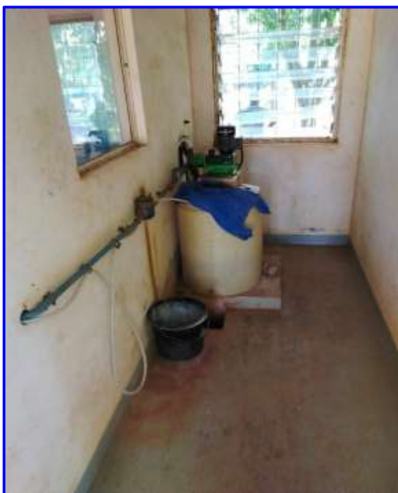
Photo 2 : Bac de chloration et pompe doseuse 4
