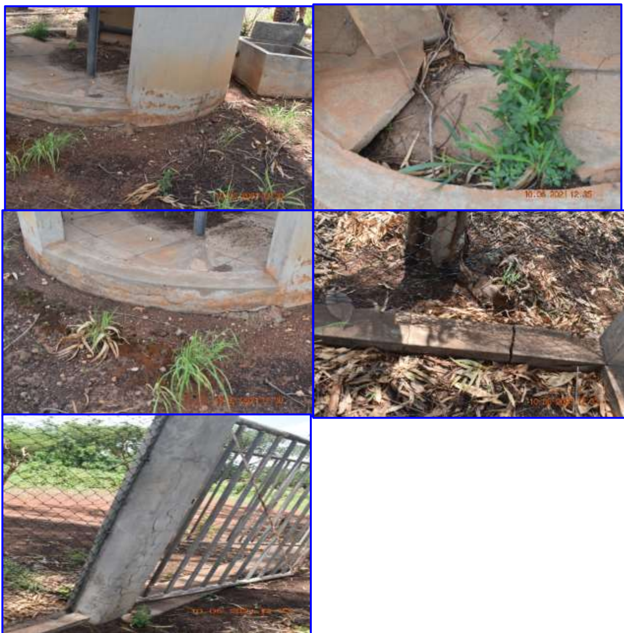
Photo 5 : Dégradations observées sur le château d'eau 7
