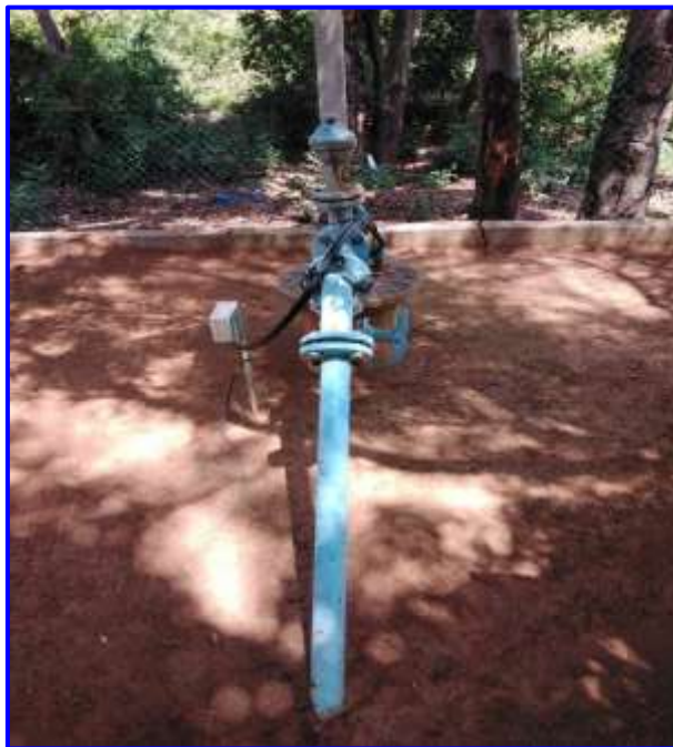
Photo 1 : Vue du forage F1 3
