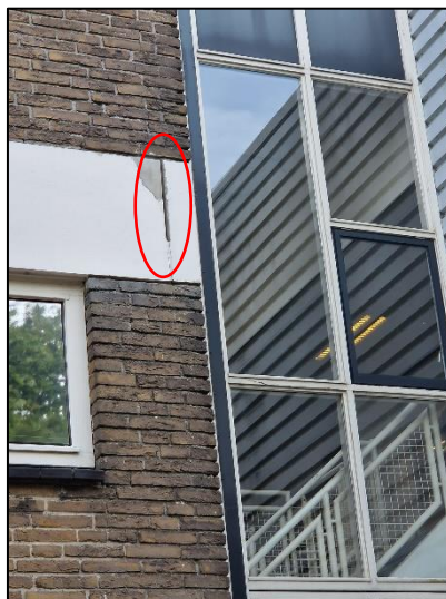
Fig. 2.11, Detailopname ontbrekende voeg (rood omrand) (bron: FF Solutions)
