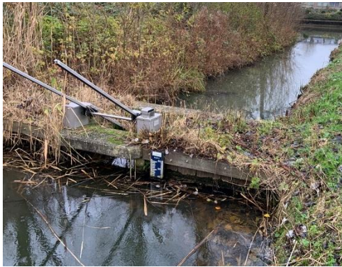
Figuur 9-4: Meetspijker in hout geplaatst terwijl er beton aanwezig was - hierdoor wordt de betrouwbaarheid gehalveerd.
