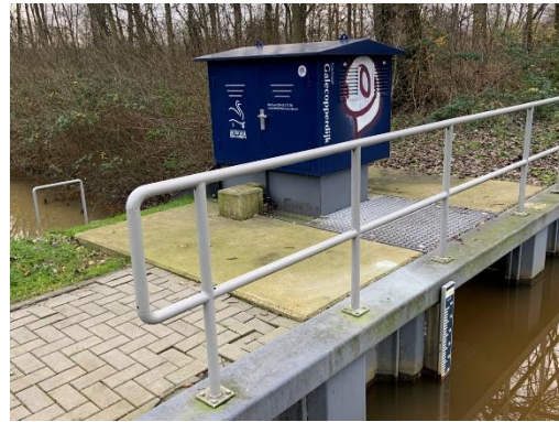
Figuur 9-3: Meetspijker geplaatst in stelconplaat - keuze damwand was beter geweest.
