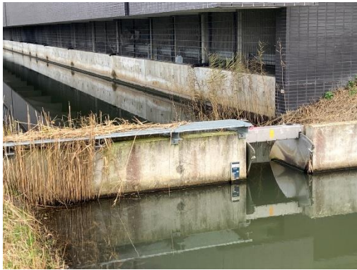
Figuur 9-2: Meetspijker bovenkant hijs oog is gekozen - niet juist er is beton aanwezig - stuw kan namelijk gedemonteerd worden.
