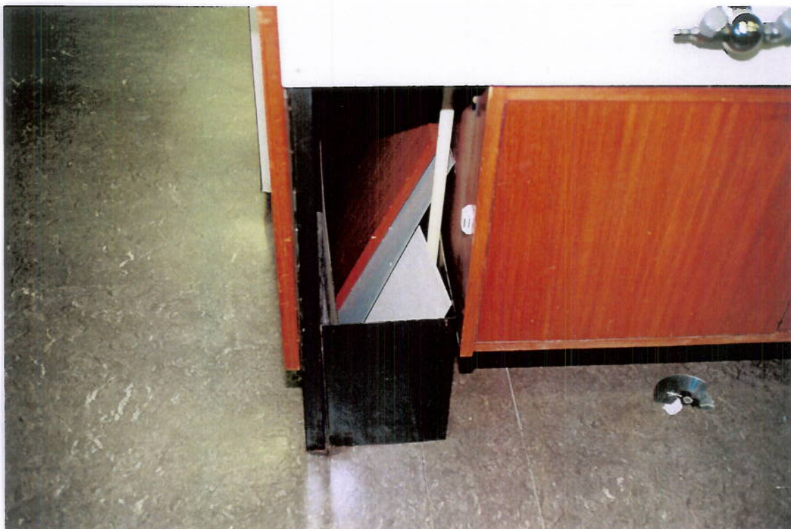
FOTO 4 (nr. 5): Asbesthoudend plaatmateriaal in de kastjes van de werkbanken in lokaal B227
