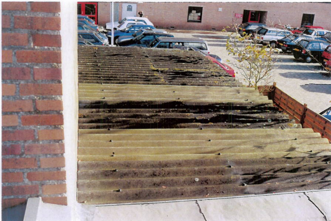
FOTO 14 (nr. 17): Asbesthoudende golfplaten als afdak naast de conciërgewoning.
