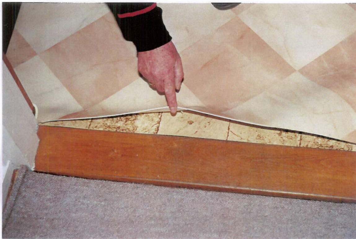
FOTO 12 (nr. 15): Asbesthoudende vloerbedekking in de keuken van de conciërgewoning.
