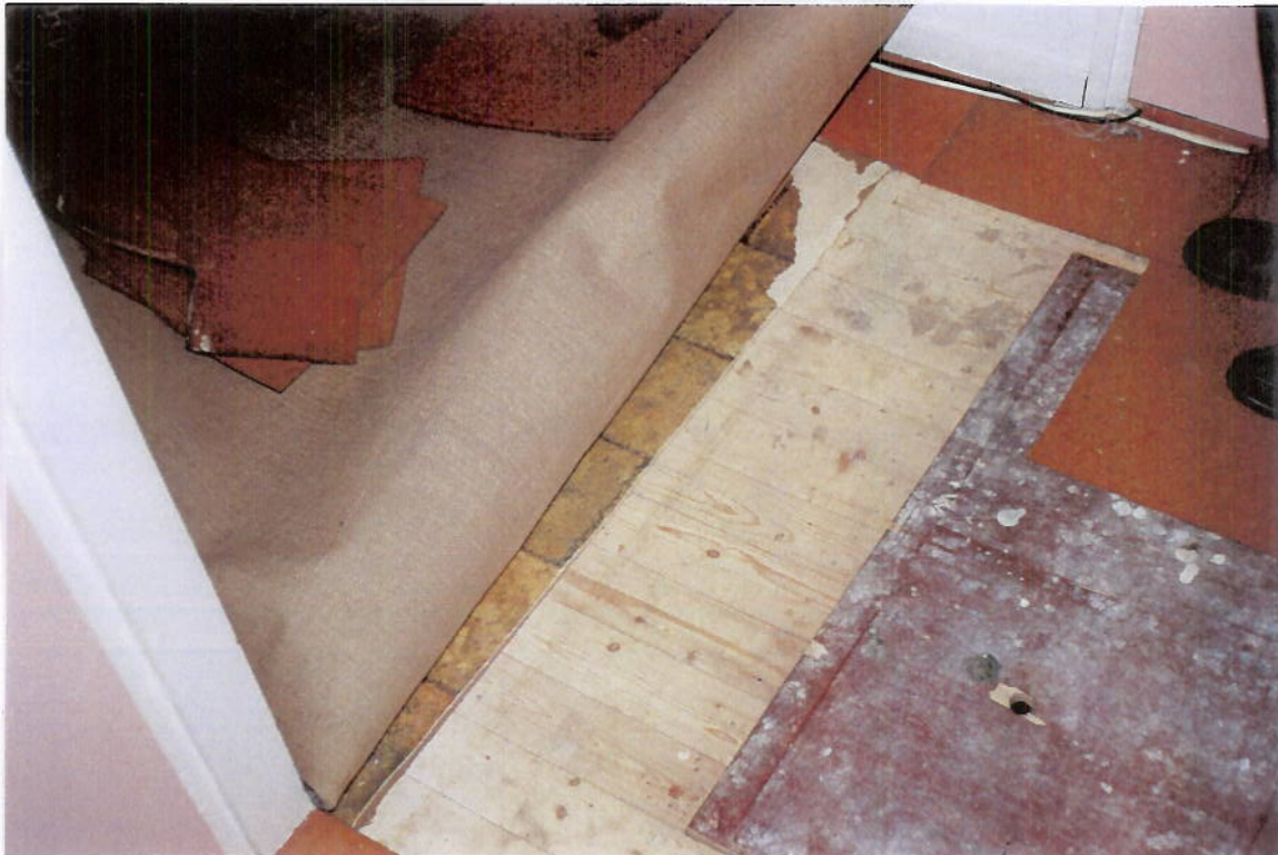
FOTO 13 (nr. 16): Asbesthoudende vloerbedekking in de hal van de conciërgewoning.
