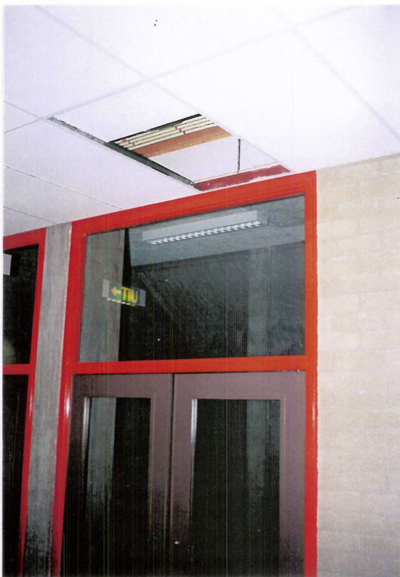
FOTO 2 (nr. 3): Asbesthoudend plaatmateriaal boven de brandwerende kozijnen in gebouw 1
