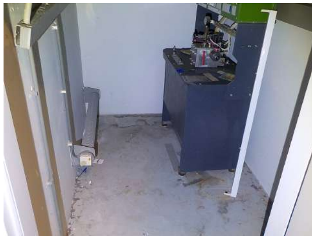
Liftmachinekamer begane grond
