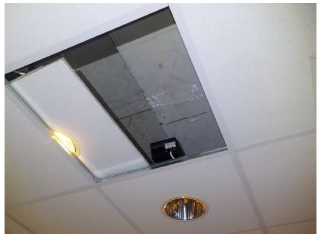
De kit is aanwezig boven het verlaagd plafond
