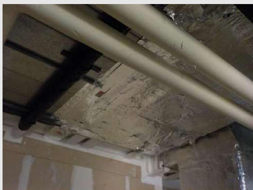
Afscherming tussen luchtkanaal en betonplafond (achter aluminium)
