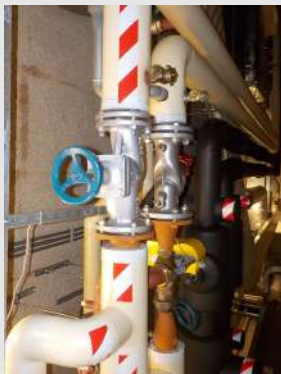
Luchtbehandelingsruimte in kelder, met asbestpakkingen
