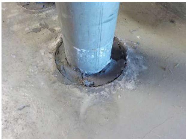
De koordresten bevinden zich in de vloerdoorvoer, onder de afdichting (deze is deels opengemaakt ter inspectie, daarna weer terug geplaatst)
