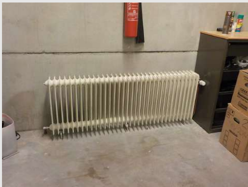
Radiator in LBH ruimte 9e verdieping
