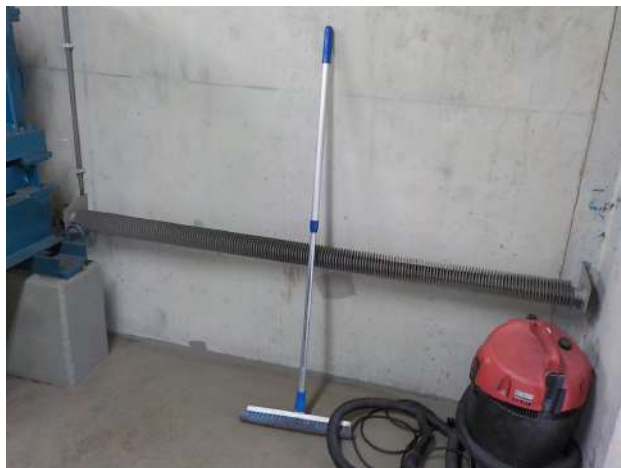
Liftmachinekamer 10e etage
