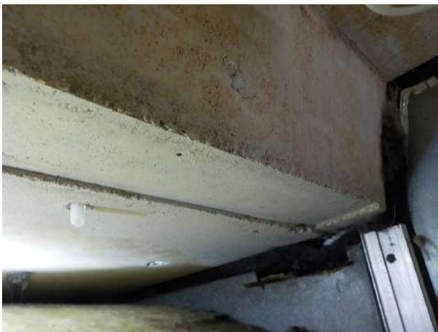
Paddestoelen dakoverstek: in het verleden slecht gesaneerd, er zijn resten verloren bekisting achtergebleven
