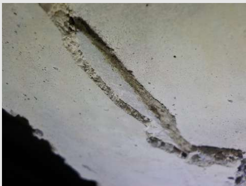
Stukje niet gesaneerde bekisting, onder beton
