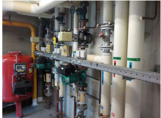
Pakkingen in cv-ruimte 10e verdieping
