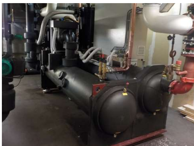
Installaties op de 9e verdieping
