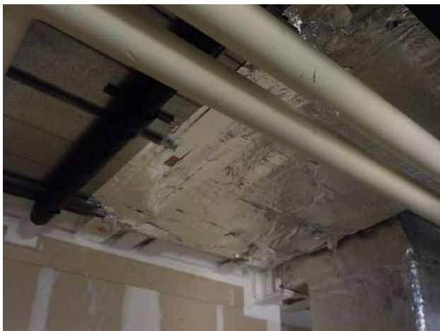
Afscherming tussen luchtkanaal en betonplafond (achter aluminium)
