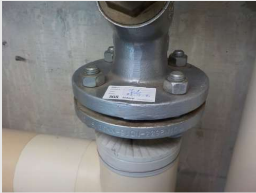
Flens met asbestpakking
