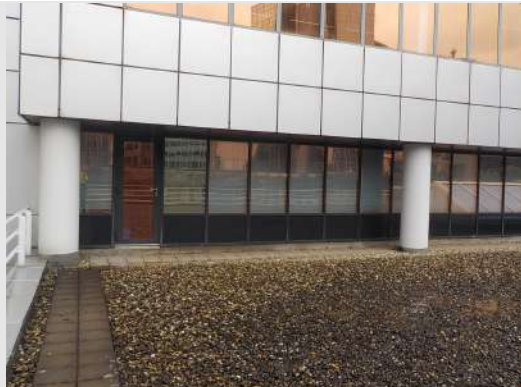
In de overstekken en achter de glaspanelen onder de ramen dient destructief onderzoek uitgevoerd te worden
