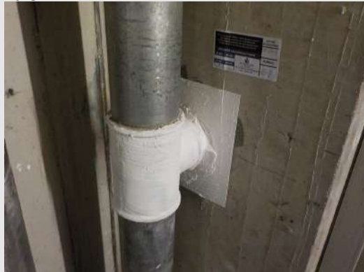
Alle doorvoeren van de brandblusleiding zijn afgedicht met Fireproof coating en glaswol (en een houten afdekplaatje). Er is kans op aanwezigheid van asbestkoord. Dit geldt ook voor alle overige doorvoeren in muren en vloeren
