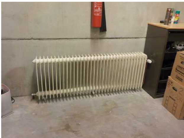
Radiator in LBH ruimte 9e verdieping
