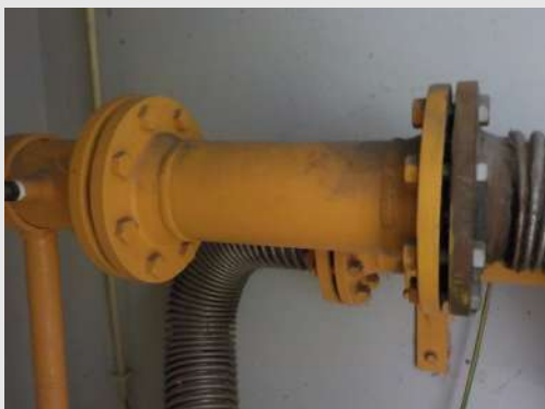
2 asbestpakkingen in de gasmeterruimte begane grond
