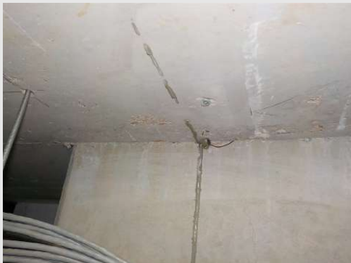
Kit op betonplafond en betonkolom
