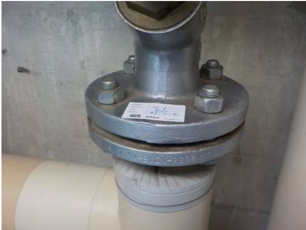
Flens met asbestpakking
