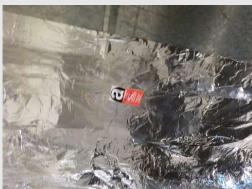
Er zijn asbeststikers aangebracht ter waarschuwing.
