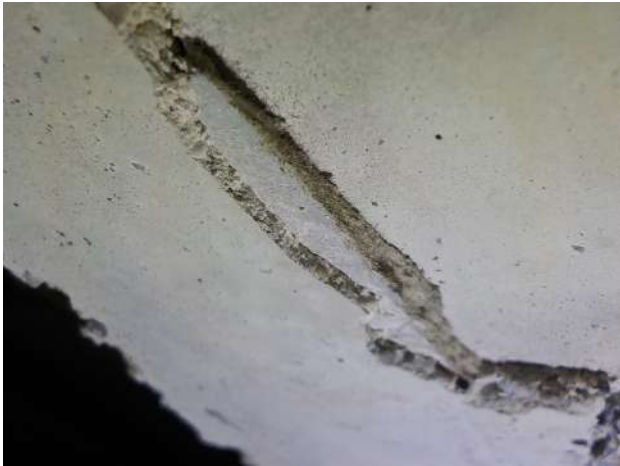
Stukje niet gesaneerde bekisting, onder beton
