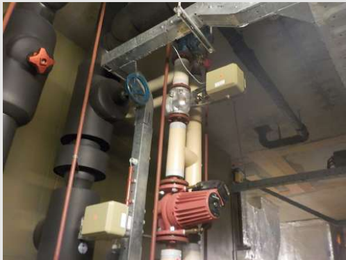
Luchtbehandelingsruimte op 9e verdieping
