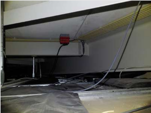
De constructie bij de Fitnessruimte en personeelsbar wijkt af: er is een stalen constructie met gasbeton dakplaten. Op deze locatie is geen verloren bekisting aanwezig
