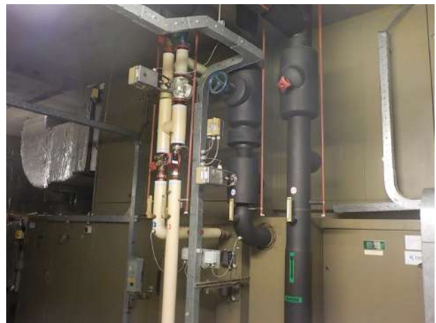
9e verdieping, met pakkingen naast de originele LBH kast
