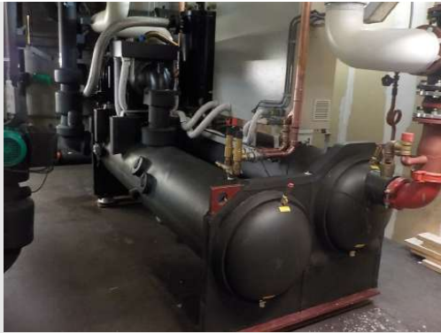
Installaties op de 9e verdieping
