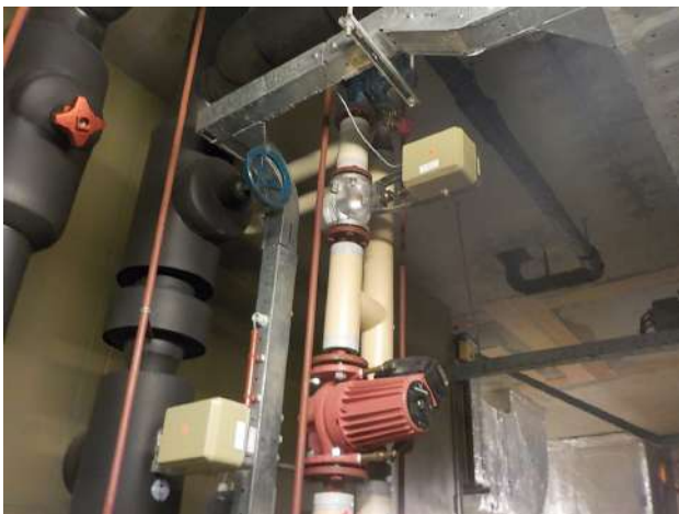
Luchtbehandelingsruimte op 9e verdieping
