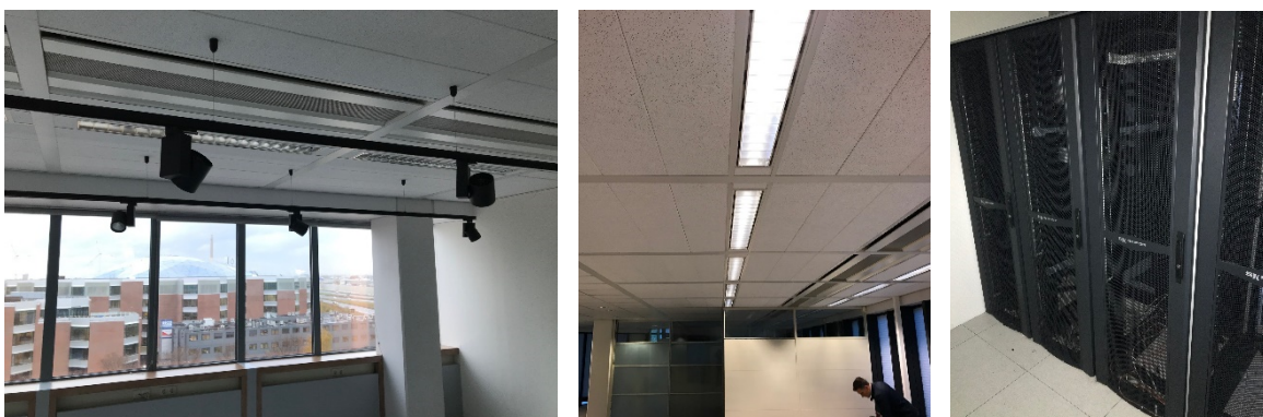
Figuur 11: a. spot/lijn verlichting, b. TL-verlichting en c. patchkast
