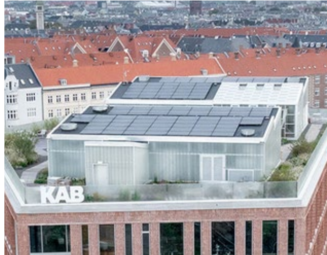
Installaties dakopbouw samenhangend en ingetoren ontworpen
