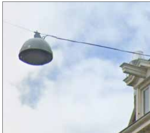
▲ Standaard armatuur hangende verlichting
