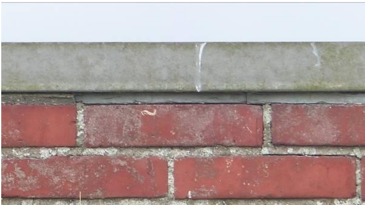
Figuur 4.3 Er bevinden zich geen holtes of openingen in het transformatorhuisje.
