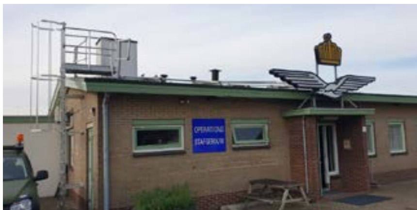
Ongewenste toevoeging van herwerk (o.a. vanuit architectonisch en materiaal oogpunt).
