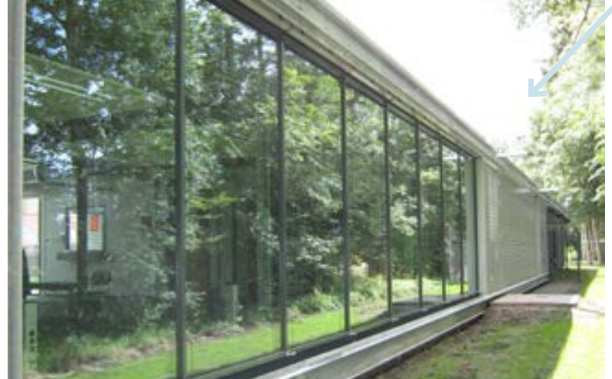
De installatieruimte is gepositioneerd op het maaiveld geïntegreerd achter gevel in plaats van op het dak.
