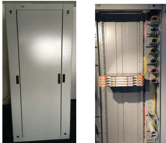
Figuur 2: Commscope GR3 ODF rack
