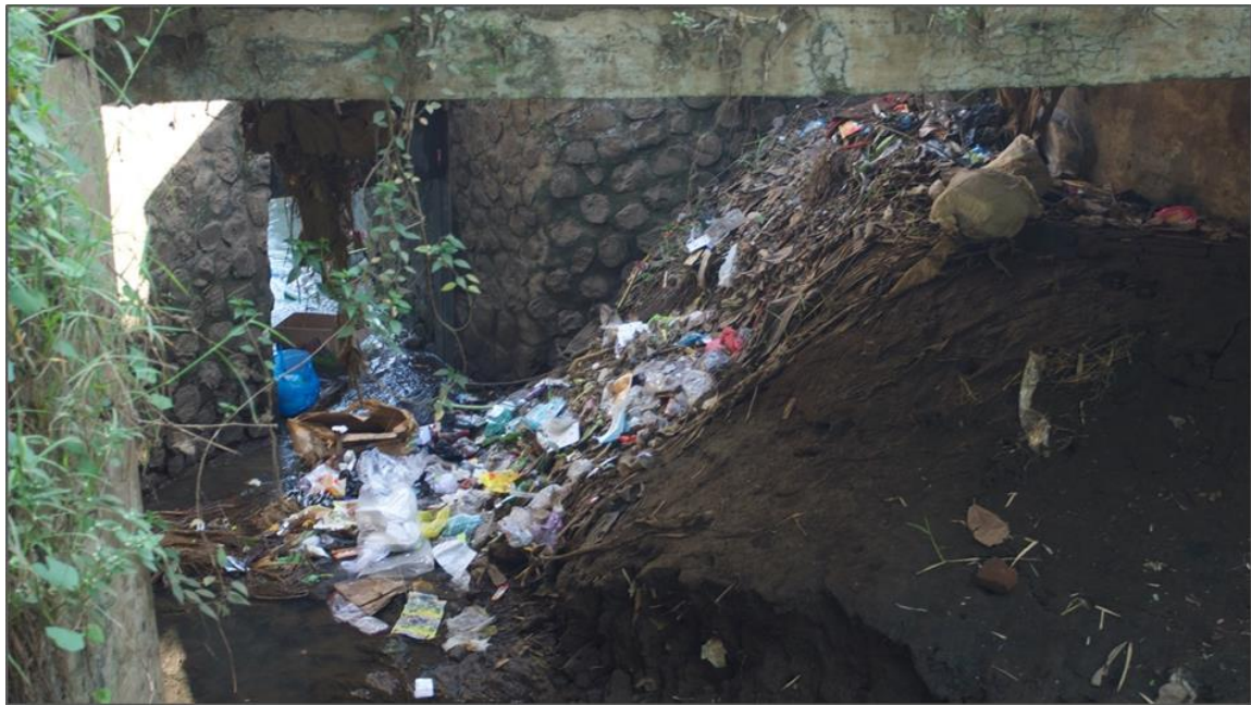
Gambar 5-23 Sampah Padat Menumpuk di Saluran Pembuangan
