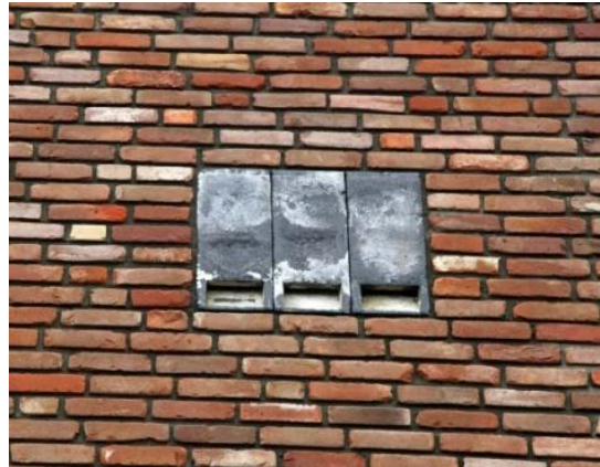
Drie vleermuiskasten naast elkaar ingemetseld
