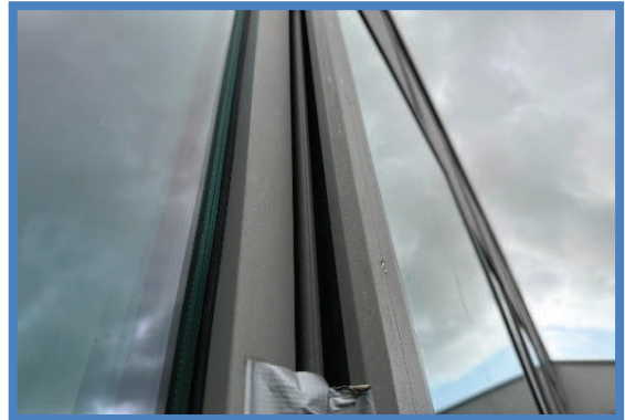
Ramen sluiten niet goed
