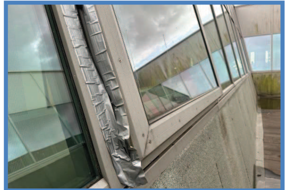
Ramen sluiten niet goed
