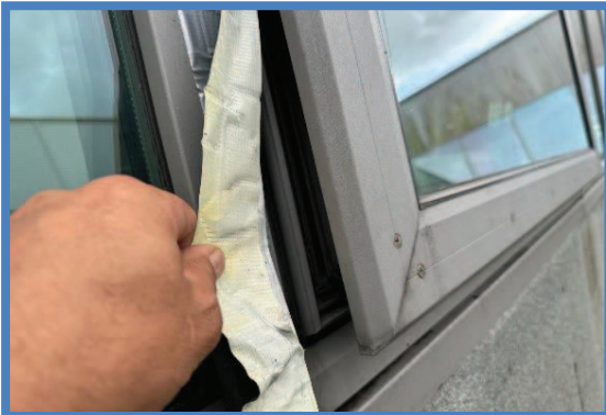
Ramen sluiten niet goed
