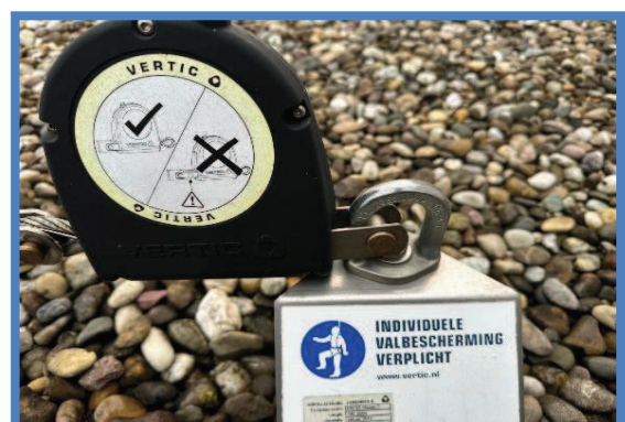
Geen keuringssticker aanwezig
