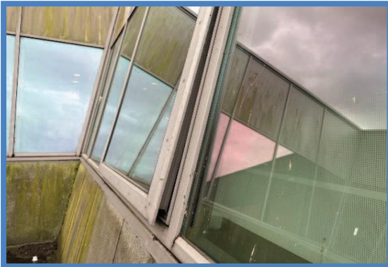
Ramen sluiten niet goed
