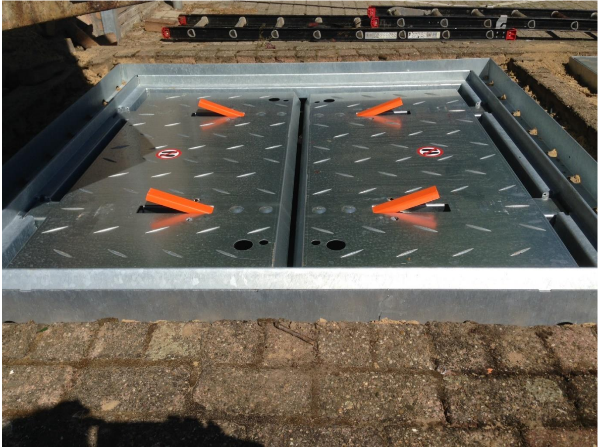
Klapvloer Bammens gemonteerd 2014 (foto 2014)
