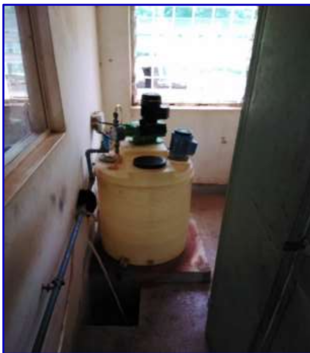
Photo 2 : Bac de chloration et pompe doseuse
