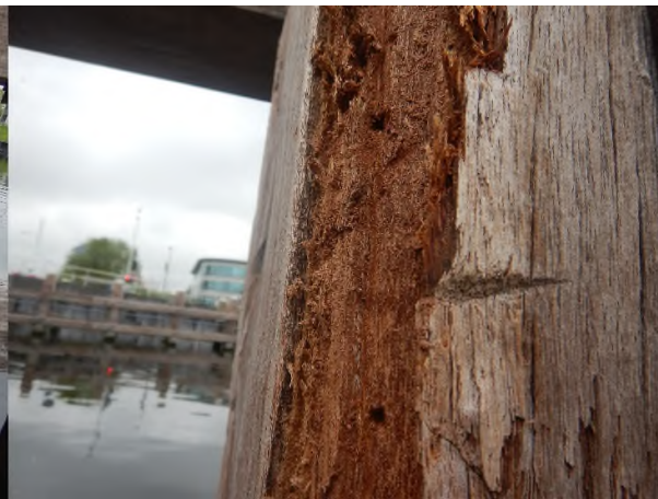
Figuur 15: Beschadiging (bruinrot) paal
